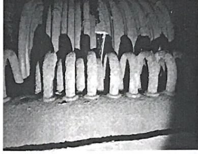
Рисунок 1 – Общий вид системы змеевиков ПВД после вскрытия
