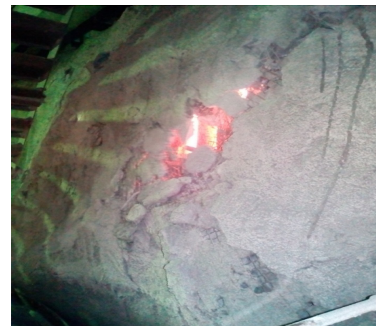
Рисунок 1 – Разрушение обмуровки котельного агрегата
