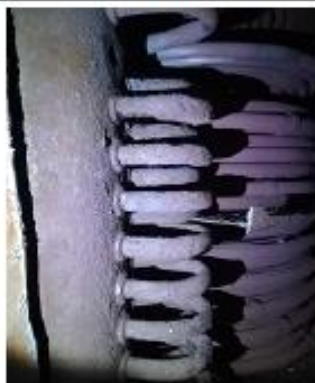
Рисунок 1 – Общий вид системы змеевиков ПВД после вскрытия
