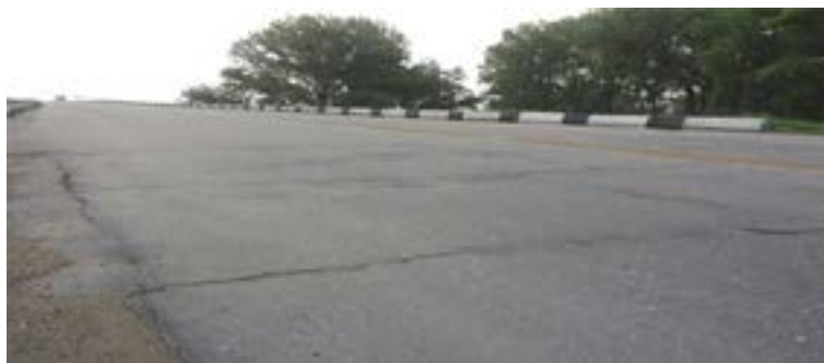
Рисунок 1 – Деформации на трассе Астана-Павлодар
